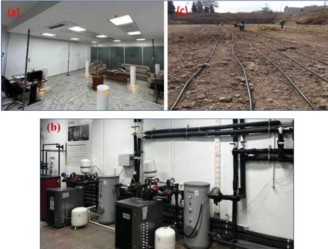
Şekil 2. Deney sisteminin, (a) radyant panellerin bulunduğu test odası, (b) ısı pompası grubunun bulunduğu mekanik oda ve (c) temel altındaki toprakta yer alan ısı değiştiricisi boruları
